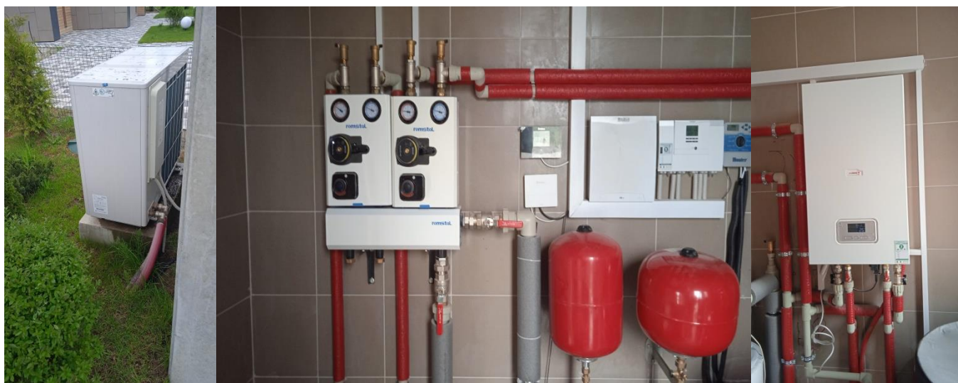
Зовнішній блок теплового насосу «повітря-вода», циркуляційної групи та резервного електричного котла
